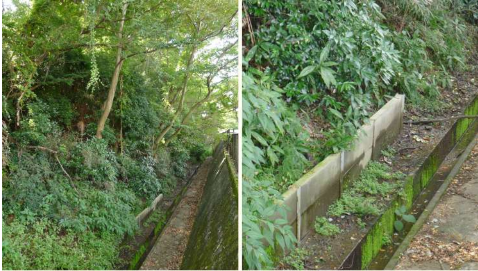
台地斜面林。外城。写真右は水が染み出した箇所を拡大撮影したもの。2021/10/06
